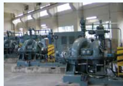
穴生浄水場 インバータポンプ
