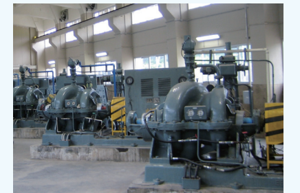
穴生浄水場 インバータポンプ
