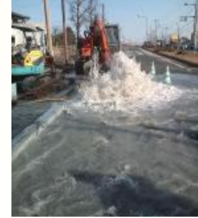
漏水現場の写真
