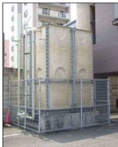
小規模貯水槽水道
