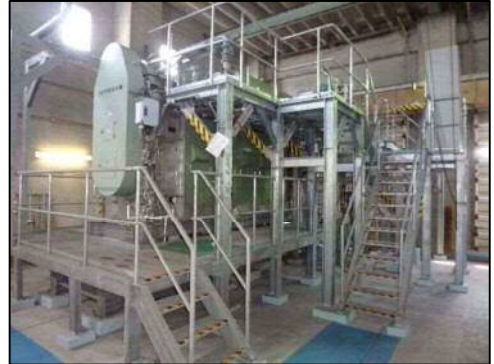
【下水道】脱水機設備の更新・高効率化
