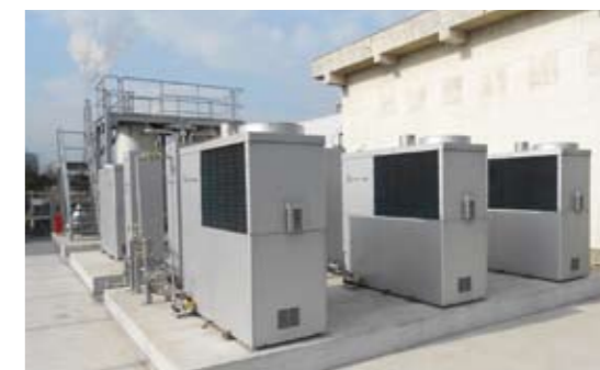
消化ガス発電 (日明浄化センター)
